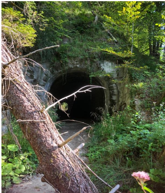
Abb. 4: Die Spuren III: befestigte Bereiche der alten Bahntrasse mit Tunnel in besonders gefährdeten Bereichen; davor abgerutschter Baum eines jüngeren Hangrutsches. Die Bahnstrecke lag über 50 Jahre brach. Die Natur ‚kommt zurück‘ (Foto: Elisabeth Schelling)
